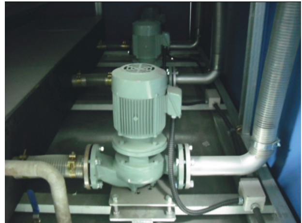
내부 물 TANK & PUMP
